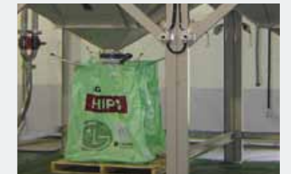
스크랩 저장 Tank & 플라곤 백 (Storage tank & Flagon bag)
